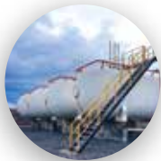
6 Citernes de stockage à Gaz
