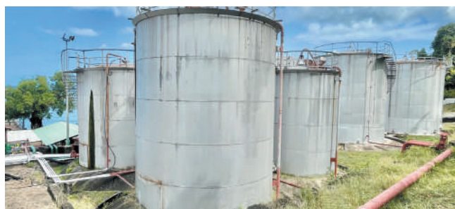
Citernes de stockage des produits pétroliers à Anjouan
