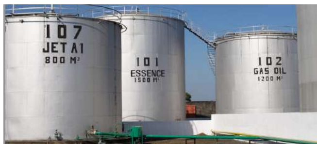
Citernes de stockage des produits pétroliers à Ngazidja
