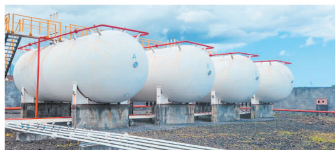
Citernes de stockage de gaz
